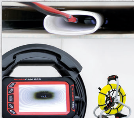
Lüftungs- und Wartungsinspektion
